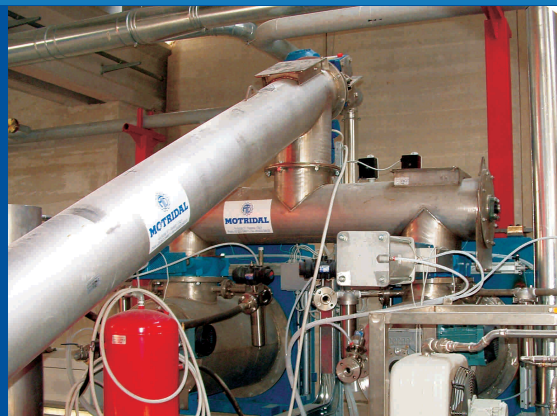
Impianto di trattamento rifiuti ospedalieri Hospital waste treatment plant
